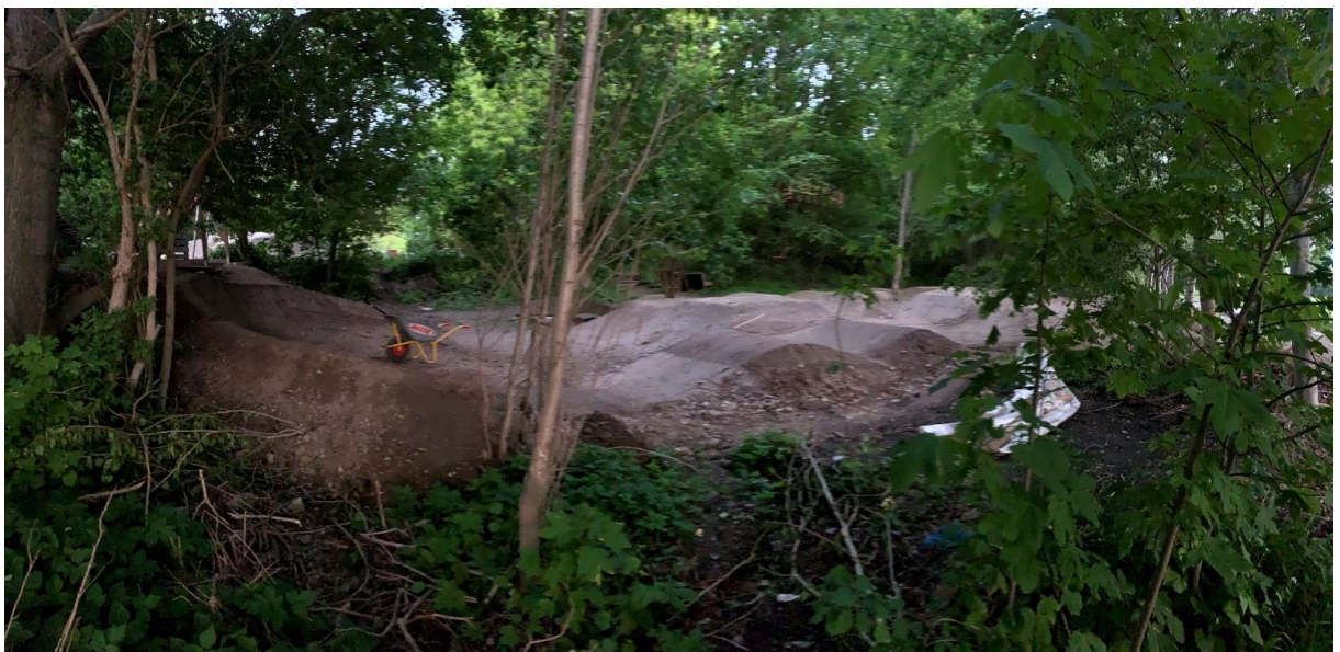
Pumptrack set udefra græsplænen og ind mod banen i retning mod kanalen og fortidsmindet Christianshavns vold Banen set ude fra halv tolv asfalt vejen (indsyn udefra beskyttelseslinjen) og hen mod fortidsmindet Christianshavn vold
